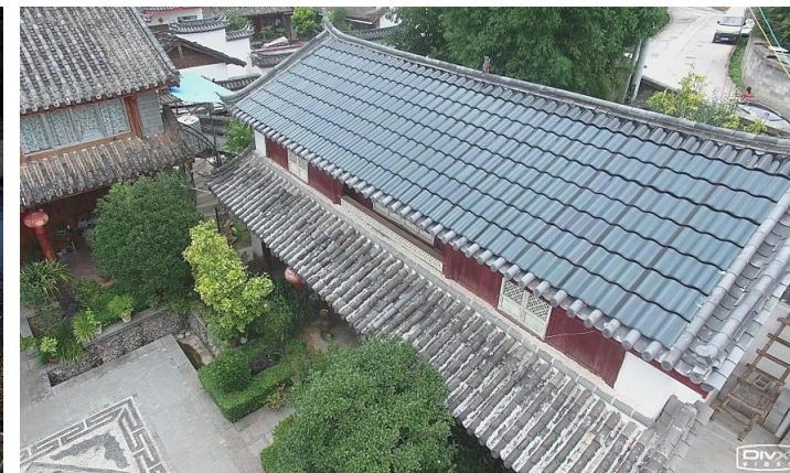
项目名称: 丽江市玉龙纳西族自治县黄山镇长水村汉瓦项目 项目亮点: 传统民族建筑结合汉瓦, 古朴融合科技感 装机容量: 6.7KW
