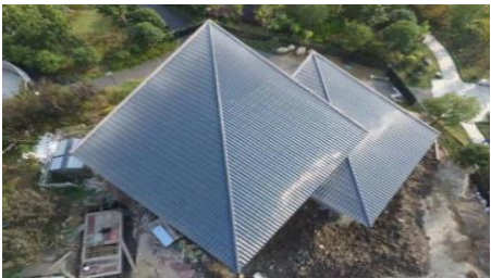
余杭汉瓦项目 2018年9月, 7Kw
