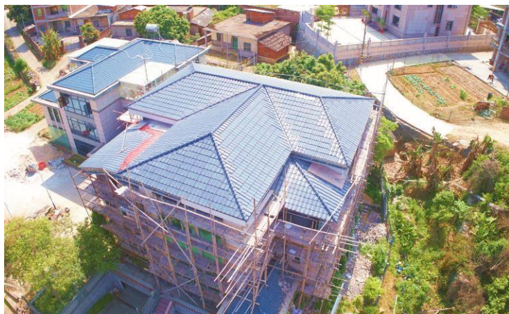
项目名称: 泉州市南安市东田镇湖山村汉瓦项目 亮点: 自建别墅, 节能环保、时尚美观, 解决日常用电问题。 装机容量: 23.4KW
