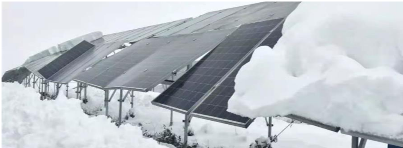
大雪重压之下，光伏电站不可忽视的倾覆风险
