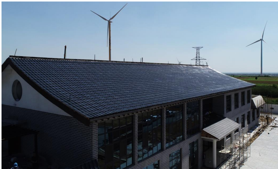
项目名称: 安阳市华能电厂汉瓦项目 项目亮点: 与风能组合共同发电 装机容量: 38.8kW
