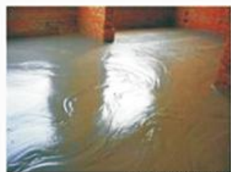
泡沫混凝土现浇未刮平
